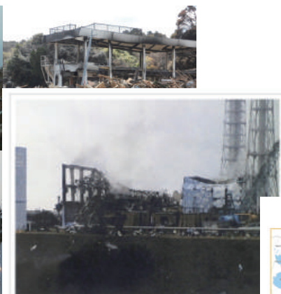
機を上げらる福島第一原発の3号機周辺(21日午後5時15分) ©東京電力提供
